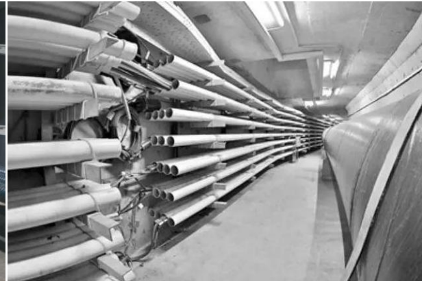
青岛市城市地下管廊
